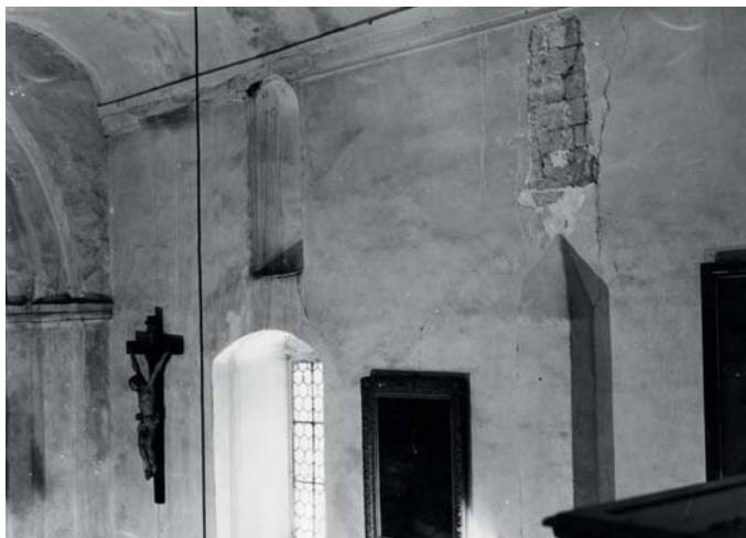
Obr. 4. Praha 8-Dolní Chabry, kostel sv. Jana Křtitele. Pohled na východní a střední část jižní zdi lodě. Vpravo horní část jehlanem ukončené příložky a sonda nad ní (foto J. Josefík, 1973?).
