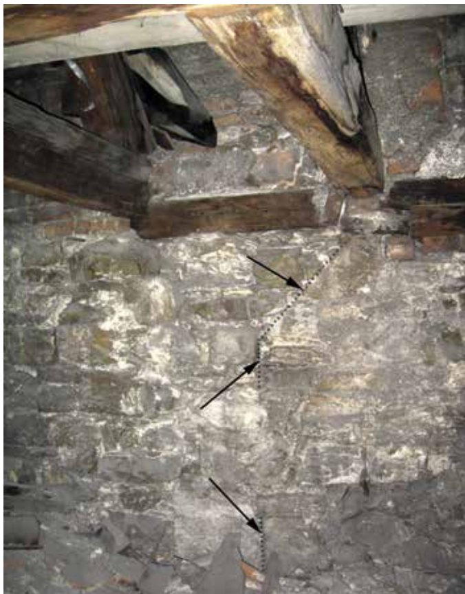
Obr. 17. Praha 1-Malá Strana, kostel P. Marie pod řetězem. Šipky označují zazděný nejzápadnější umístěný opěrný pilíř severní zdi presbytáře protaženého chóru (v místě předpokládaného provizorního uzavření chóru). V těle pilíře je zřetelná druhotná, pravděpodobně pozdně gotická, plomba vyzdřená kromě jiného z cihel (foto autor, 2010).
