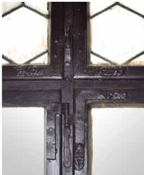
Obr. 10. Praha 1-Malá Strana, čp. 485, Velkopřevorský palác. Detail vikýřové výplně č. 3 – spodní rám s křídly, pohled z interiéru (foto V. Bartošová, 2013).
