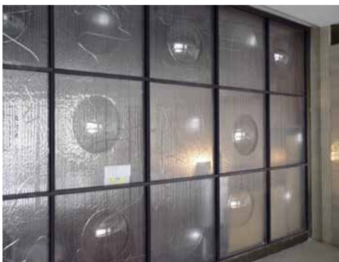
Obr. 30. Praha 6-Dejvice, čp. 2450, Sušická 20. Skleněná dělící stěna mezi místností s bazénem a chodbou, autor B. Hejlek (foto autorka, 2013).
