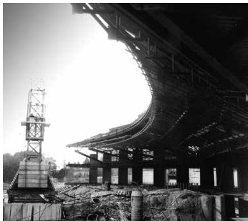
Obr. 6. Praha 6-Dejvice, čp. 2450, Sušická 20. Stavební jáma objektu s ohraničením po obvodě pilotovými stěnami (foto archiv prof. A. Navrátila).
