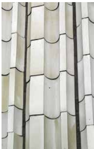
Obr. 10. Praha 6-Dejvice, čp. 2450, Sušická 20. Detail keramického obkladu obvodového pláště objektu dle návrhu Š. Kotrby. Jižní fasáda 6. NP (foto autorka, 2013).
