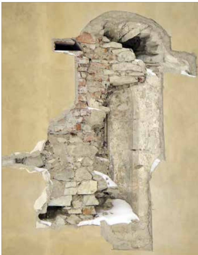
Obr. 5. Praha 15-Hostivař, kostel Stětí svatého Jana Křtitele, plášť apsidy. Nálezová situace jižního okna apsidy před opětovným zazděním (foto L. Bartoš, 2010).
