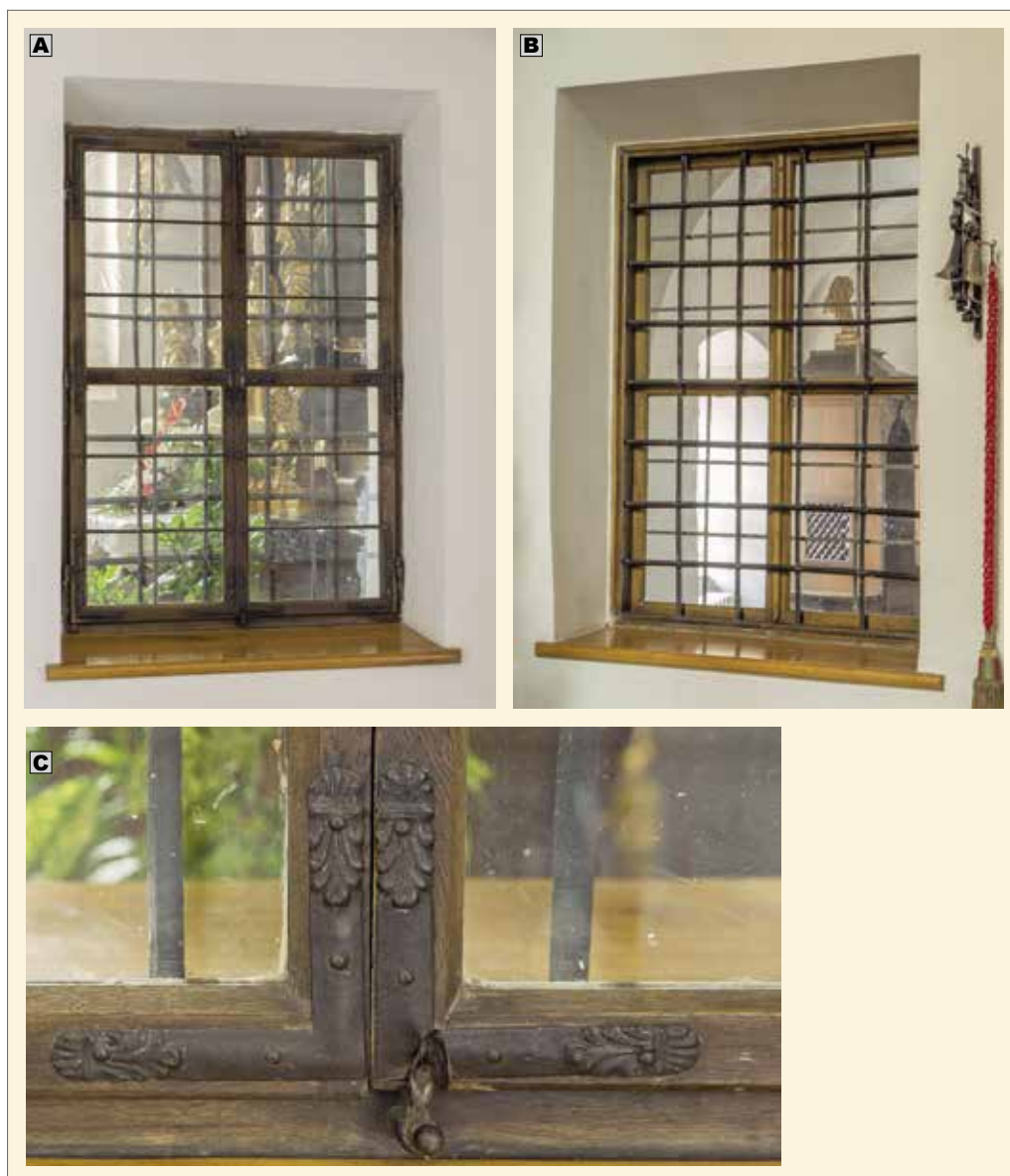
Obr. 7. Praha 1-Hradčany, kostel Panny Marie Andělské. Okno O6. A – celkový pohled ze zpodvědní chodby; B – celkový pohled z kaple Panny Marie; C – detail spodních rohovníků (foto P. Havlík, 2017).
